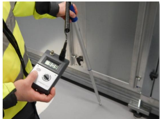
Kuva 105. Kosteuseroa IV-koneen vieressä lattiassa.
