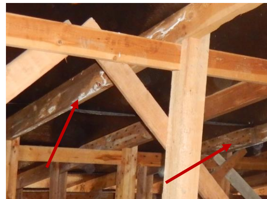
Kuva 113. Kosteusjälkiä kattoristikon yläpaarteissa.
