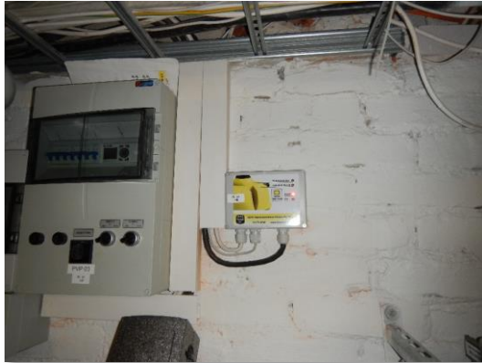
Kuva 11. Rasvanerottimen hälytin oli häiriötilassa.
