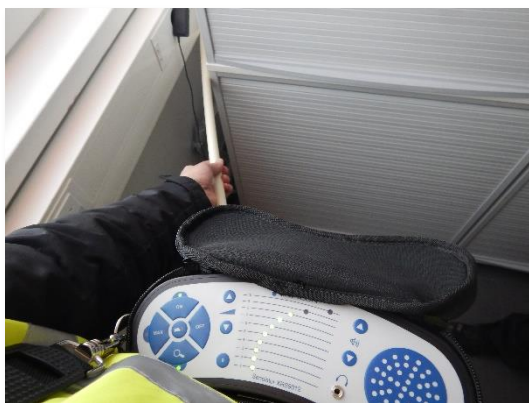
Kuva 98. Ilmanvuotoa ulkoseinärakenteesta, toimisto B136.
