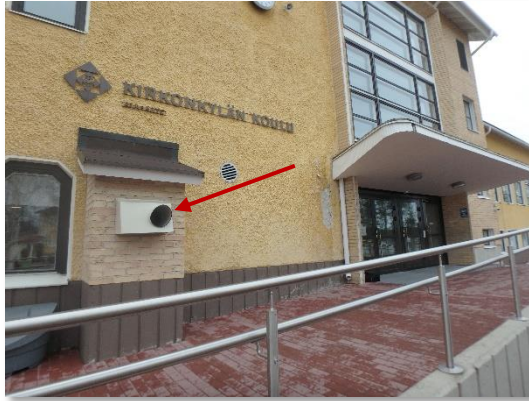
Kuva 82. Jäteilman seinäpuhallus- ja ulkoilmalaite sisäänkäynnin vieressä.
