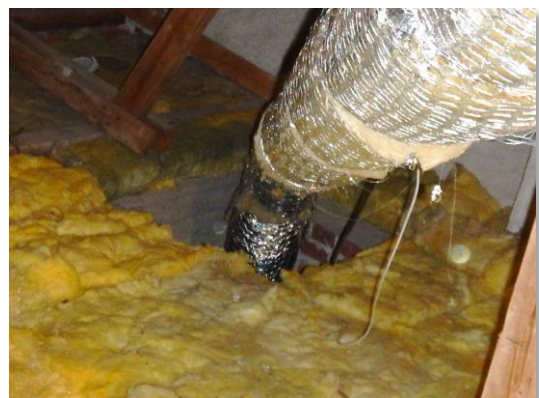
Kuva 74. Avonainen yläpohjalaatan läpi tehty hormi/aukko.
