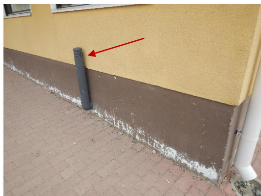
Kuva 101. Tuuletuspaalu rakennuksen vierustalla.
