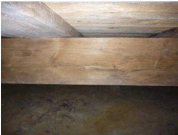
Kuva 25. RA6. Alapohjarungon pinnalla kosteusjälkiä ja vähäistä kasvustoa.
