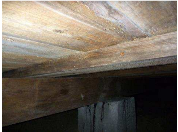
Kuva 24. RA6. Alapohjarungon pinnalla kosteusjälkiä ja vähäistä kasvustoa.
