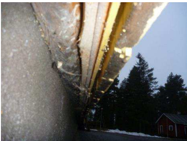
Kuva 60. Vanhan osan ulkoverhouksen tausta ei tuuletu.
