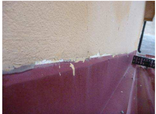
Kuva 68. Seinänostopellin sauma ei ole tiivis seinäpintaan.
