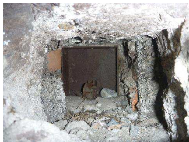
Kuva 27. Tuuletusaukot olivat kiinni tutkimushetkellä.
