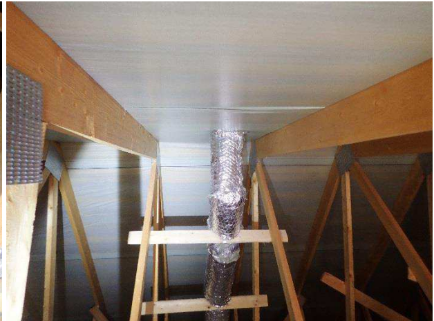
Kuva 106. Aluskate on asennettu liian tiukalle, aluskatteelle päätyvän veden poistuminen hankaloituu.
