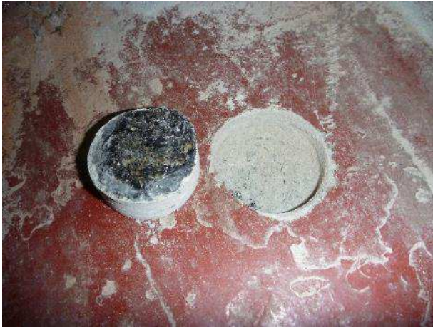
Kuva 29. RA9. Pintavalun alla on bitumimassa.
