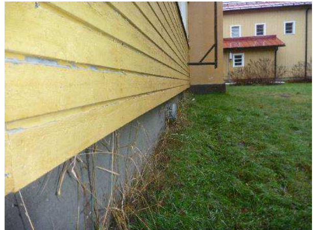
Kuva 59. Kuva vanhan osan ulkoverhouksesta. Maalipinta hilseilee paikoin.
