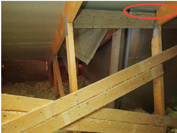
Kuva 107. IV-hormin kohdalla aluskate asennettu puutteellisesti. Kate katkaistu hormin yläpuolella.
