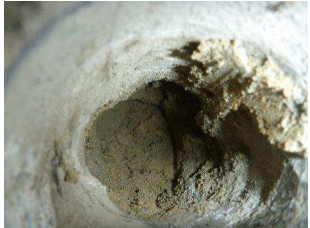
Kuva 32. RA11. Betonilaatan alla täyttömaa on märkää.
