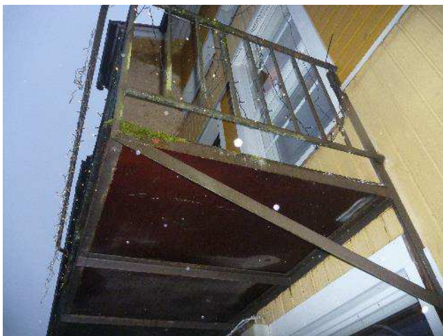
Kuva 81. Lattiavaneri on pehmentynyt vesisateen ja lumensulamisen vaikutuksesta.
