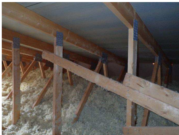
Kuva 104. Räystäät ovat umpinaiset, yläpohjan tuulettuvuus on heikko.
