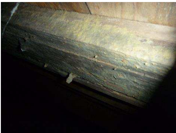
Kuva 21. RA6. Alapohjarungon pinnalla homekasvustoa.
