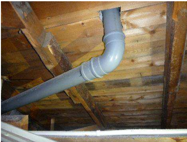
Kuva 75. Yläpohjassa on eristämätön ja kannakoimaton viemärinuuletusputki.
