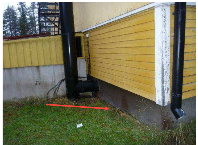
Kuva 7. Hakepoltinhuoneen kohdalla on paikallisesti asennettu patolevy.
