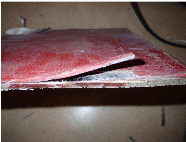
Kuva 118. Vinyylilaatan alla mustaliima (todennäköisesti asbestipitoista).
