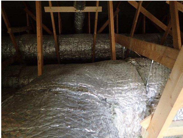
Kuva 105. IV-putket on lämmöneristetty ja kannatettu asianmukaisesti.
