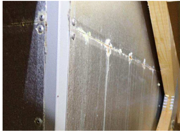
Kuva 108. IV-hormin vaakasaumojen kohdalla vedenvalumajälkiä.
