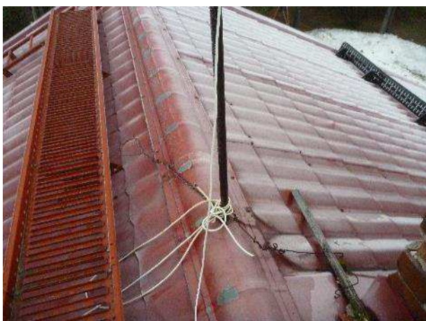
Kuva 71. Antennin läpivienti ei ole tiivis.
