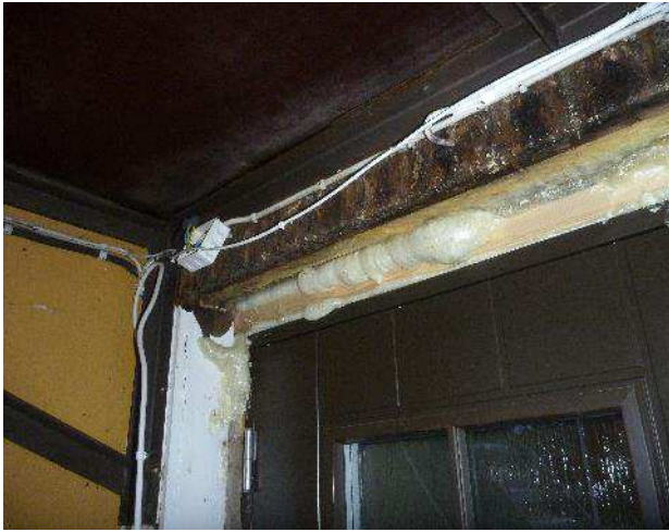
Kuva 82. Lattivanerin päälle satava vesi on kastellut seinärakenteen.
