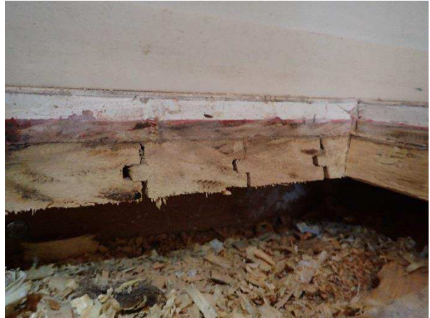
Kuva 117. Välipohjan eristeet ovat painuneet ja mahdollistavat ilman liikkumisen välipohjatilassa.
