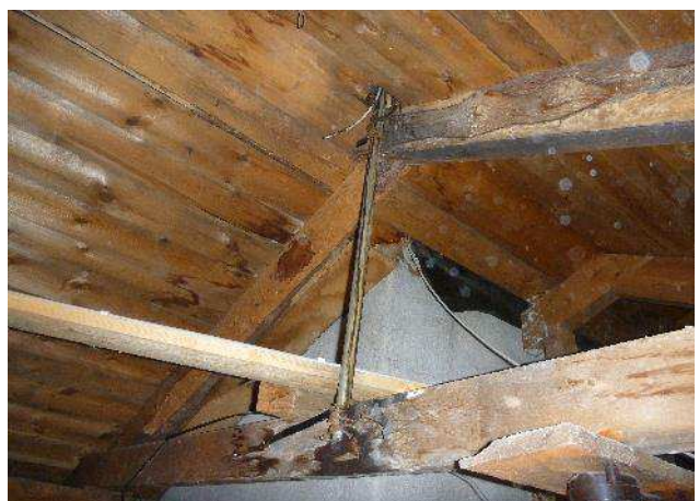
Kuva 72. Antennin läpiviennin ympärillä on veden valumajälkiä.
