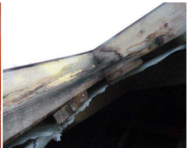
Kuva 98. Yläpohjan kulkuluukun reunoilla on kosteusjälkiä.
