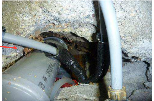
Kuva 64. Läpivienti ei ole tiivis.
