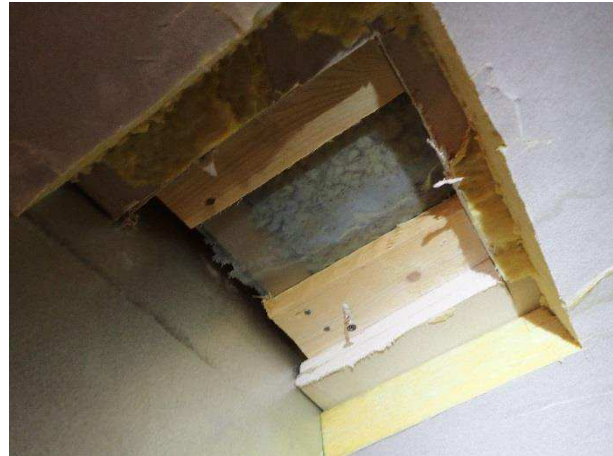
Kuva 114. HS-muovi ei ole ilmatiivis ja villalevy suoraan hormissa kiinni.
