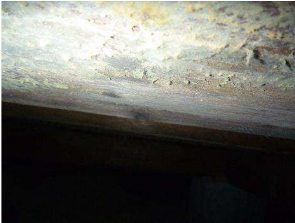
Kuva 23. RA6. Alapohjarungon pinnalla homekasvustoa.
