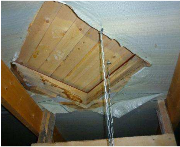
Kuva 99. Aluskate on asennettu puutteellisesti.
