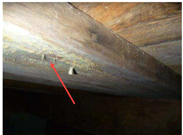
Kuva 22. RA6. Alapohjarungon pinnalla homekasvustoa ja lahoa.
