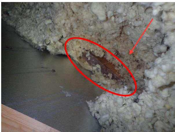
Kuva 109. Hormin juurella laudassa kosteuden jälkiä. Mikrobinäyte M1 otettu eristevillasta nuolen kohdalta.
