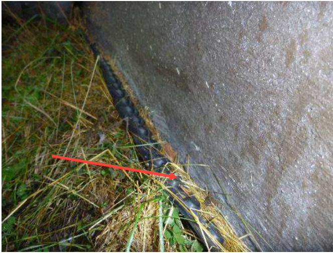
Kuva 8. Patolevyn yläreunassa ei ole tiivistyslistaa.
