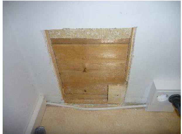
Kuva 43. RA7. Kipsilevyn takana vanha sisäverhouslevy ja umpilaudoituus.
