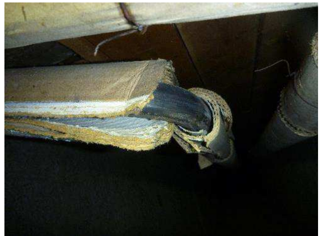
Kuva 79. Putkikanaalissa olevat putkieristeet.
