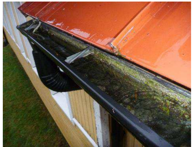
Kuva 96. Röystäskourut ovat roskaista ja osin jäässä.
